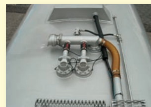
Gasumstellventil auf Dach 2-mal Kippventil
